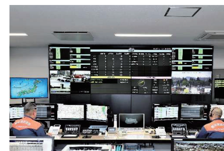
消防・救急通信指令システム
