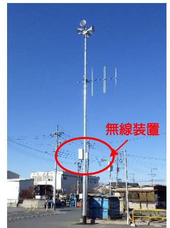
無線装置を高所設置した 屋外子局の設置例
