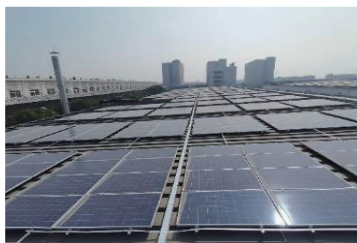
富士通將軍中央空調（無錫）有限公司の屋根に新設した太陽光パネル
