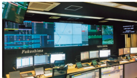
住民のみなさまの安心・安全を支える消防・救急通信指令システム
